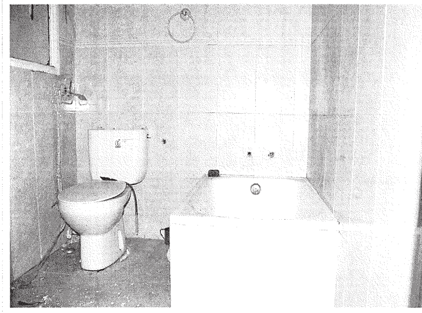
SANITARIOS Y GRIFERÍAS - ESTADO ACTUAL
