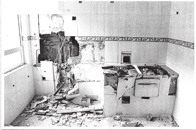
REVESTIMIENTOS CERÁMICOS – ESTADO ACTUAL
